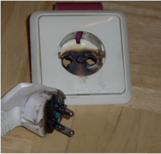
220 V - Steckdose mit Kurzschluss
